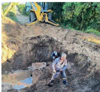
Foto 4 - Acesso aos assentamentos destruídos em Arroio Grande
